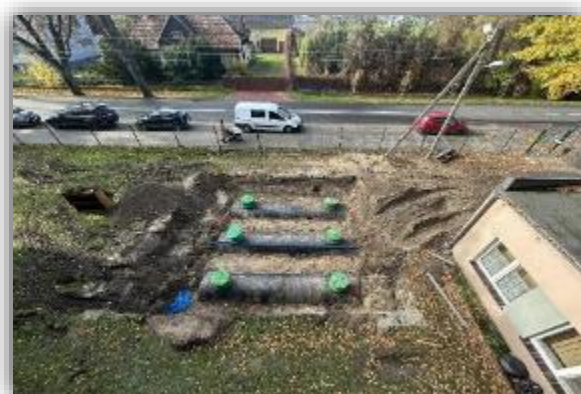
3 zbiorniki magazynujące wodę deszczową przy szkole podstawowej w Tuchorzy
